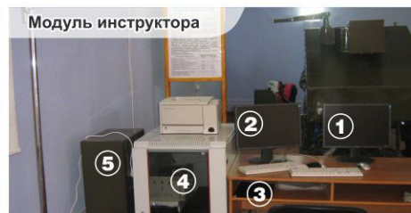
1 – монитор внешней камеры; 2 – монитор управления; 3 – клавиатура инструктора; 4 – телекоммуникационный шкаф; 5 – шкаф силовой
